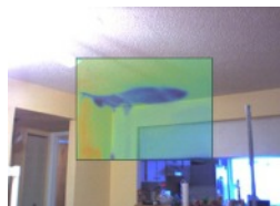
Fugas de Agua
